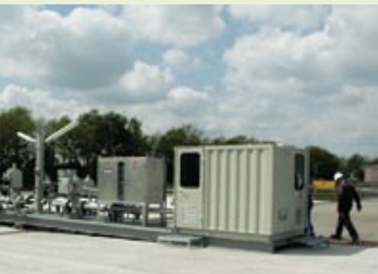
De mini-installaties die geplaatst gaan worden op de locaties Moddergat, Lauwersoog en Vierhuizen. Ze worden skids genoemd. Ze zijn niet hoger dan ruim twee meter.
